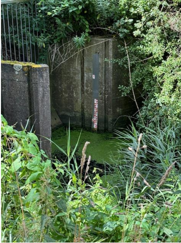
Figur 2-12 Pumpestationens indløb fra kanalen
