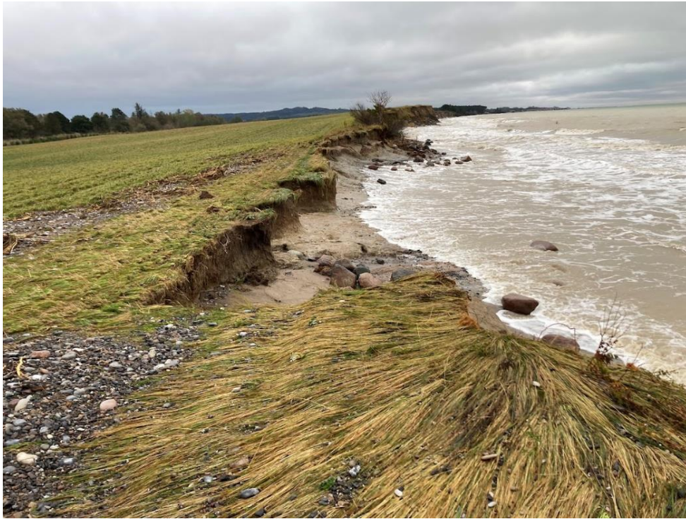
Figur 4-31 Foto af strækningen lige øst for pumpestationen med beskadigelse fra stormfloden
