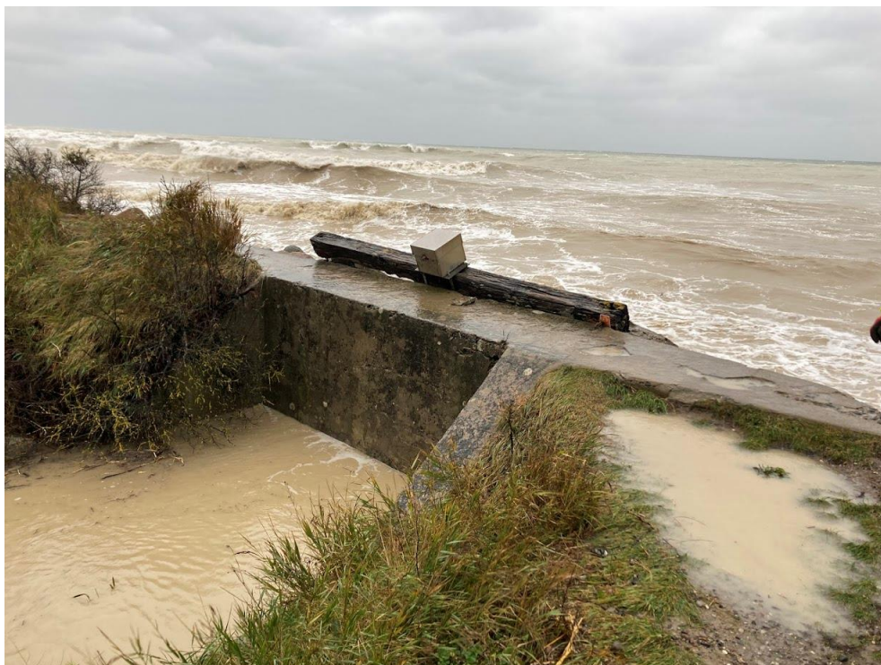
Figur 4-22 Foto fra udløbet i havet ved pumpestationen (foto fra digelaget)
